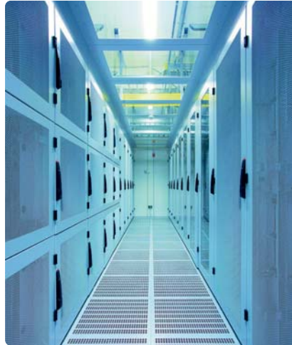
Der sogenannte Kaltgang mit Server-Schränken (Racks) links und rechts. Durch die vollständige Kapselung (Einhausung) des Kaltgangs strömt die kalte Luft durch die Bodengitter direkt in die Frontseiten der Server, ohne sich mit der warmen Abluft zu vermischen (Abb. 2).
