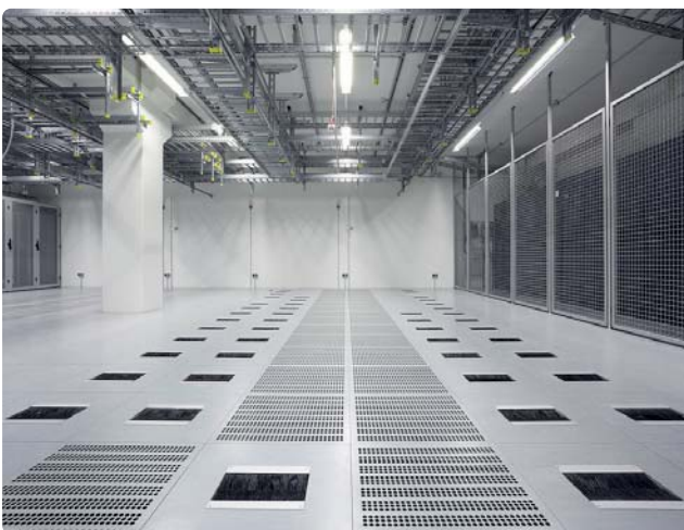
Durch die Gitter im Doppelboden (Bildmitte) strömt kalte Luft aus. Links und rechts davon werden die Server-Schränke aufgestellt (Abb. 4).
