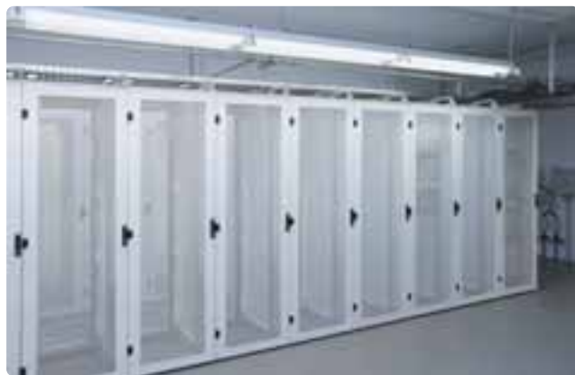
Mit den 700 Millimeter breiten Racks wird die Stellfläche im Darmstädter Rechenzentrum DARZ optimal ausgenutzt.
