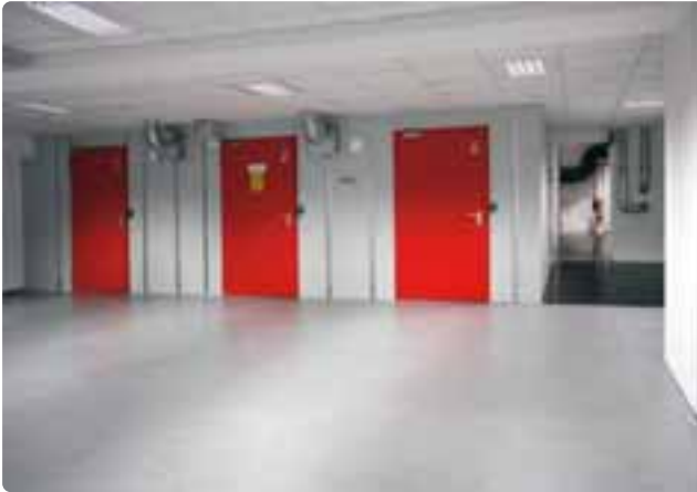
Auch die Aneinanderreihung von mehreren Sicherheitsräumen ist möglich. Hier befinden sich drei nebeneinanderliegende Technikbereiche in Grundschutzräumen.
