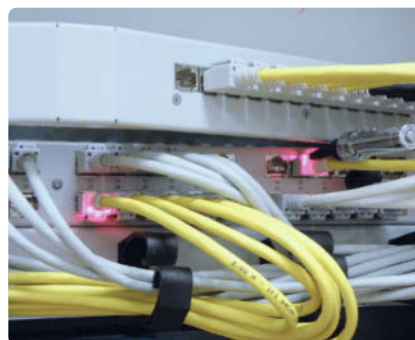
Quelle: ZVK Bei LED-Patchkabeln wird ein Detektor in entsprechende Pins am Stecker angeschlossen, und die Enden des Patchkabels leuchten rot auf. Das gibt es auch für LWL-Patchkabel.
