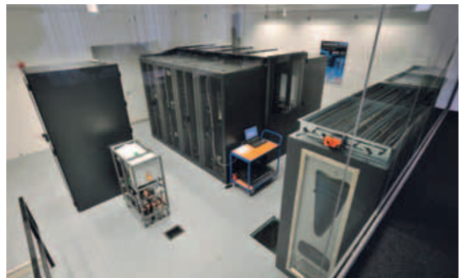
Blick vom Kontrollcenter in den Serverraum des DataCenter 2020
