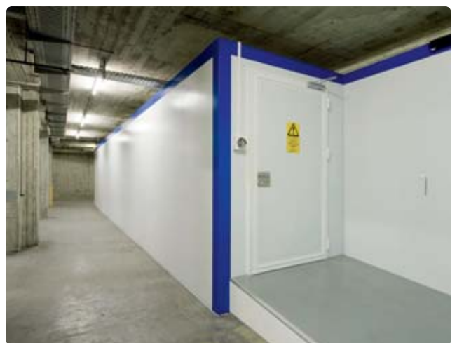
Hinter einer mit Fingerprint-Scanner gesicherten Tür befindet sich das Aligia-Rechenzentrum im Keller des Donaukurier-Verlagsgebäudes (Abb. 4).
