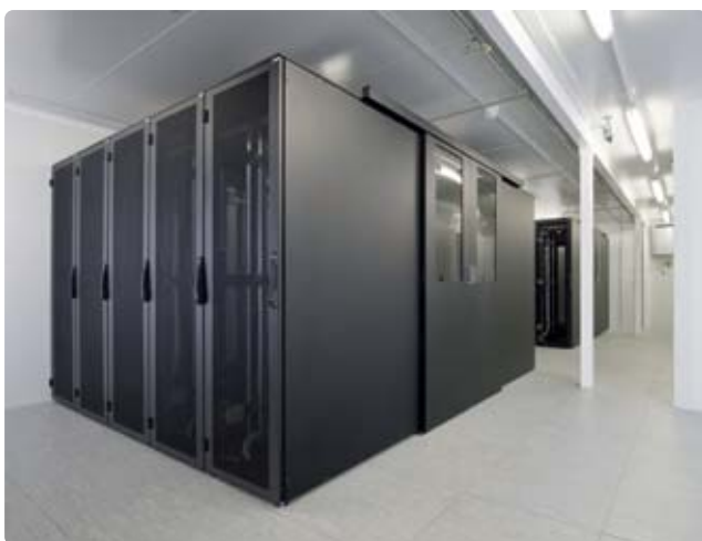
Die Einhausungslösung Cold Section ist ein integraler Bestandteil des Klimatisierungskonzepts im Aligia-Rechenzentrum (Abb. 1).
