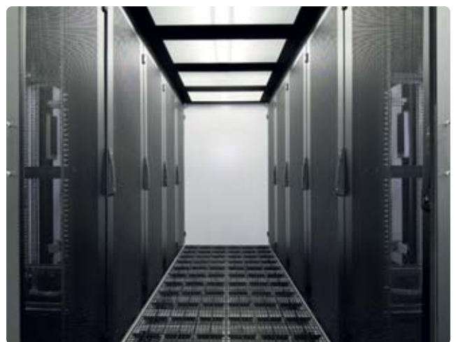
Das modulare Doppelbodensystem – hier Rahmen mit je neun Lüftungskacheln – erzielt einen freien Querschnitt von bis zu 60 Prozent (Abb. 2).
