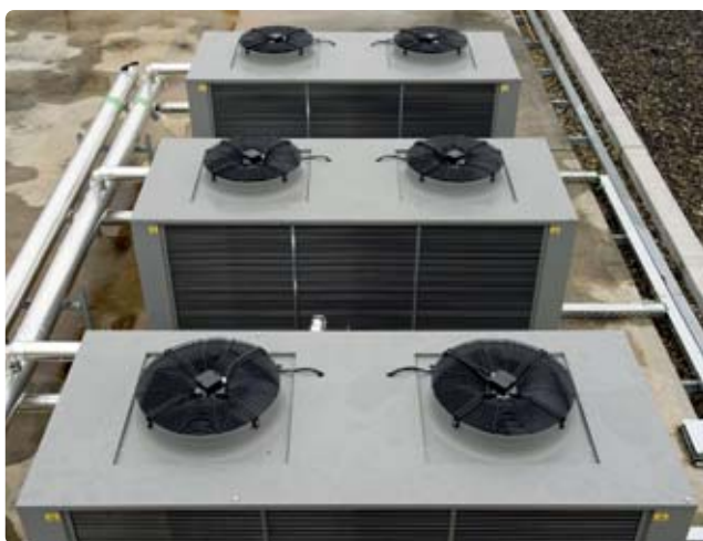
Das Zusammenspiel aus aktiver Kühlung (Bild), Freikühlung und Einhausung sorgt für eine hohe Energieeffizienz in einem Rechenzentrum (Abb. 3).
